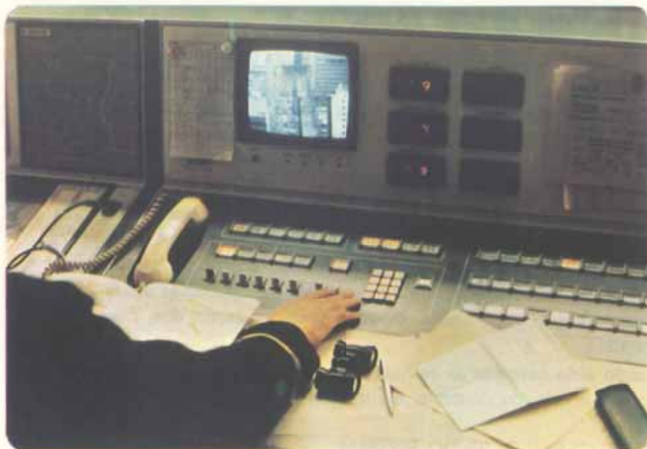
FIG. 19 — DETALHE DO "CONSOLE" DE CONTROLE DE TRÁFEGO, TÓQUIO.
