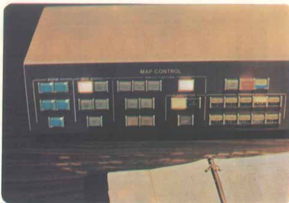
FIG. 24 — DETALHE DO "CONSOLE" DE CONTROLE DE TRÁFEGO, MIAMI.
