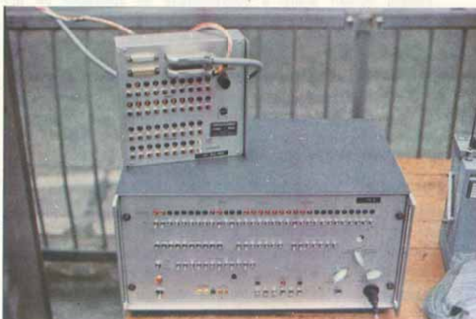
FIG. 25 — EQUIPAMENTOS DE TESTE DE CONTROLADOR ELETRÔNICO, LONDRES.
